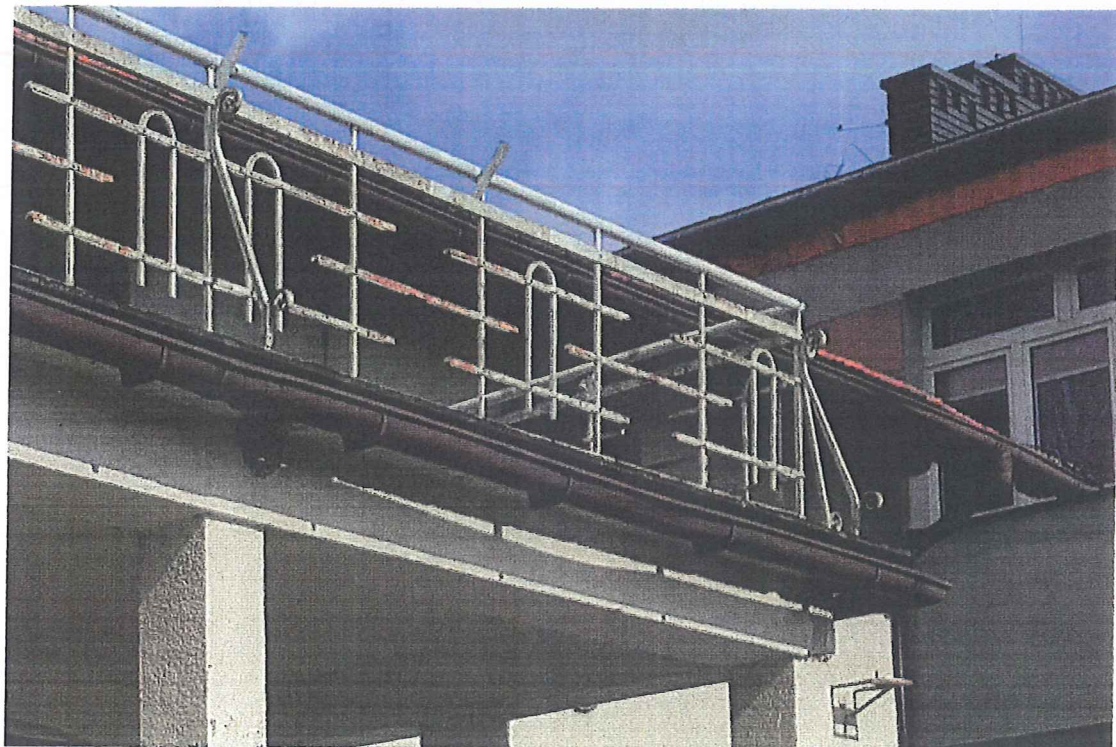
32. 33. Skorodowane balustrady i obróbki blacharskie na tarasie.
