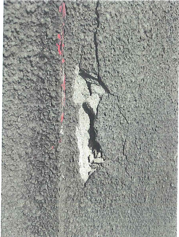
8. Odspojone tynki elewacyjne
