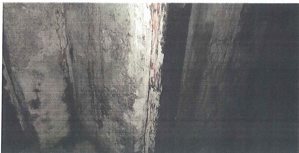
26. 27. 28. mury i stolarka piwnicy zawilgocone i zaatakowane przez grzyby
