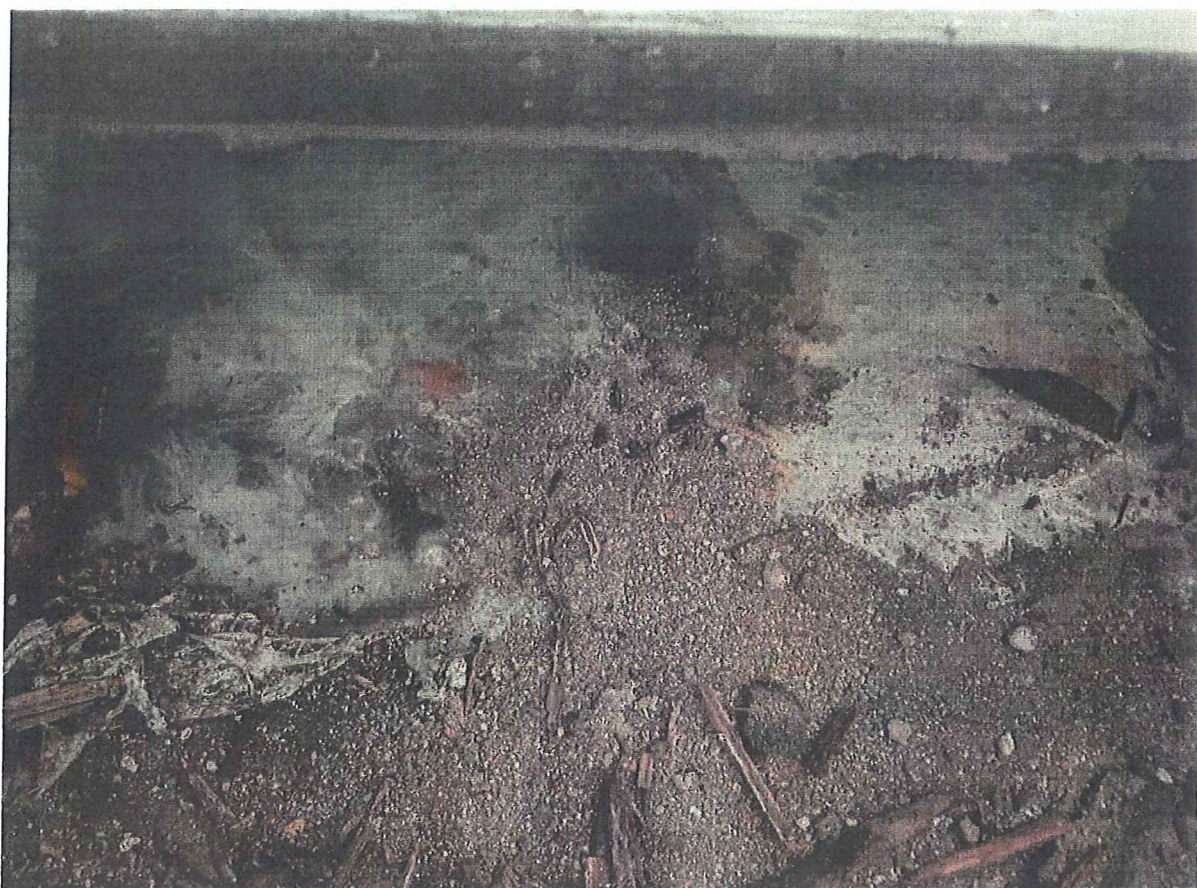
24. Fragmenty konstrukcji podłogi w sali zaatakowanej przez grzyba domowego właściwego.
