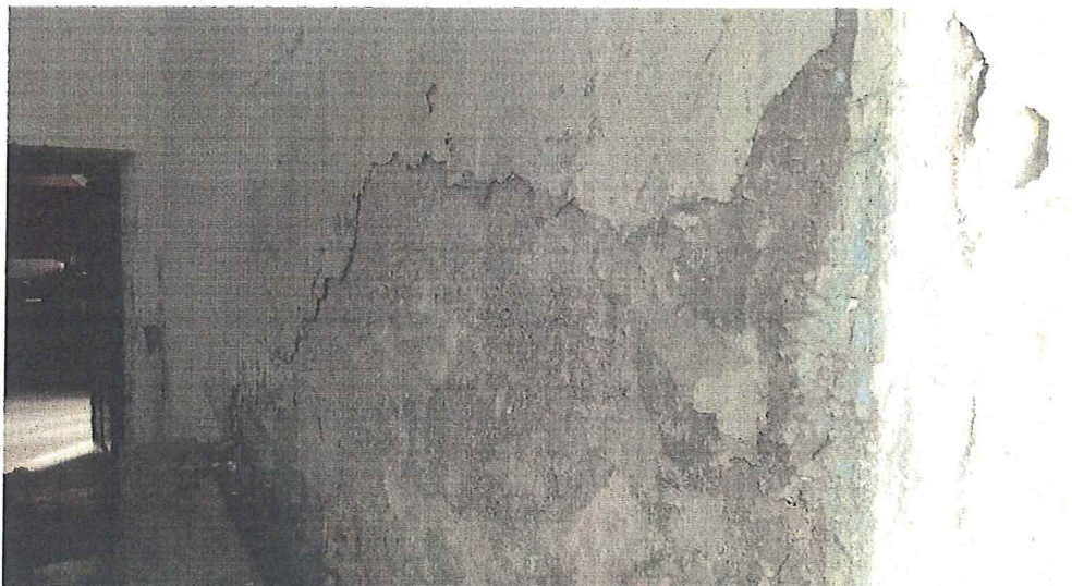
18. 19. 20. Destrukcyjny wpływ wilgoci na mury.
